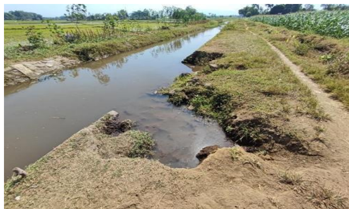
Gambar 3. Gambaran Kondisi Fisik Saluran Sekunder Dawuhan
